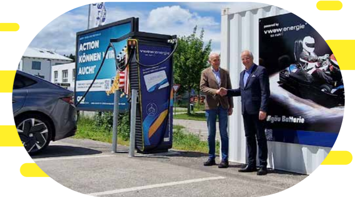
VWEW-Geschäftsführer Stefan Fritz (rechts) bei der Übergabe des Batteriespeichers an Josef Scheibel, Betreiber und Inhaber der Halle
