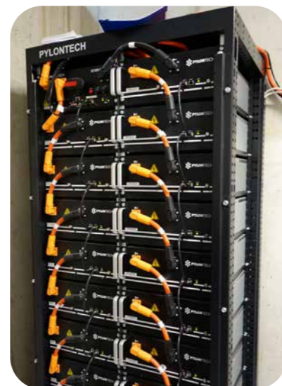
PV-Anlage und Batteriespeicher sind in Betrieb.
